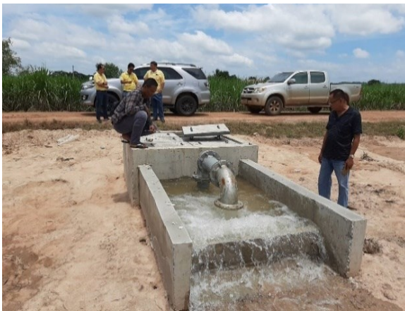
จุดจ่ายน้ำสู่พื้นที่รับประโยชน์ของโครงการ ที่ก่อสร้างเป็นระยะตามแนวท่อส่งน้ำ
